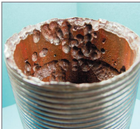
Рисунок 1.1 – Коррозионное повреждение НКТ из углеродистой стали, вызванное углекислотной коррозией [2].
