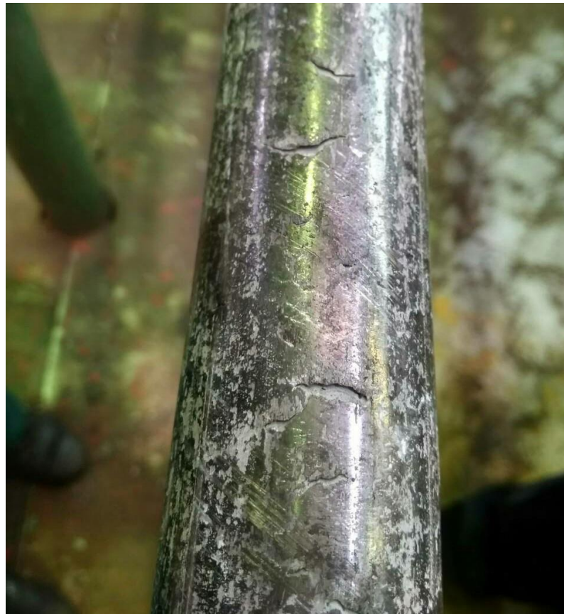
Рисунок П2.4. Трещины на трубах \varnothing 42 \times 4 мм из стали 12X18H10T.
