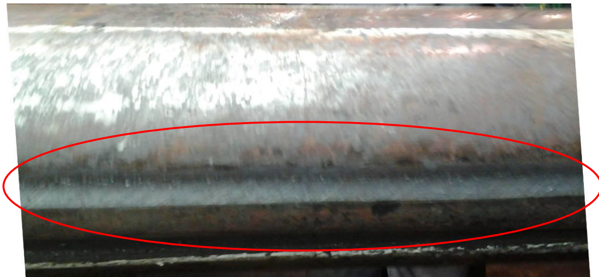
Рисунок 4.28 – Ужимы на наружной поверхности трубы
