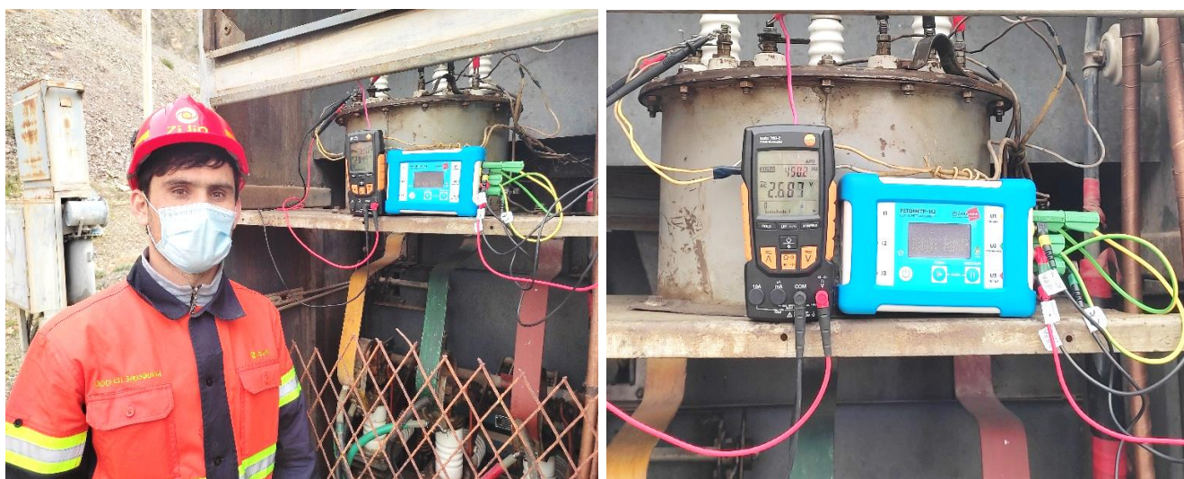
Рисунок 4.6 – Испытания по разработанной методике в распределительной электрической сети напряжением 6 кВ карьера «Таррор»
