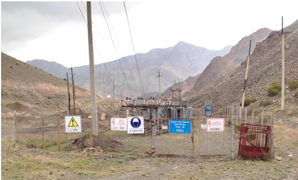
Рисунок 4.5 – Внешний вид подстанции «Вачагна» 35/6 кВ
