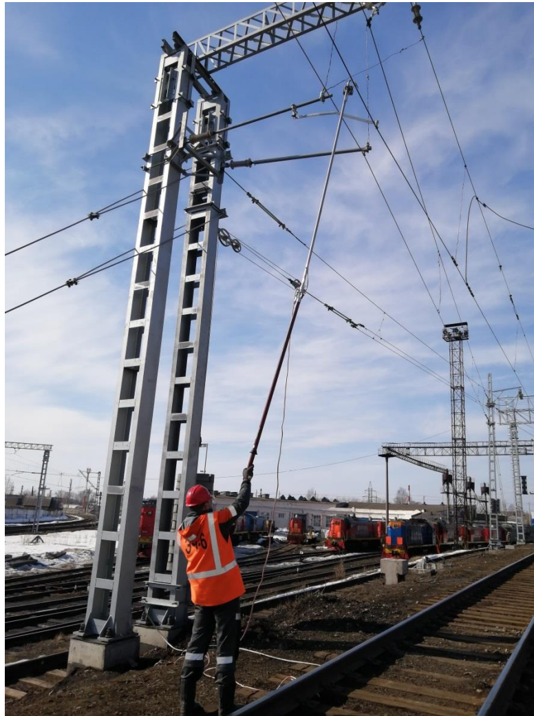
Рисунок 3.14 – Заземление контактной сети переносной заземляющей штангой с контролирующим устройством ст. Чусовская 29.03.2020г
