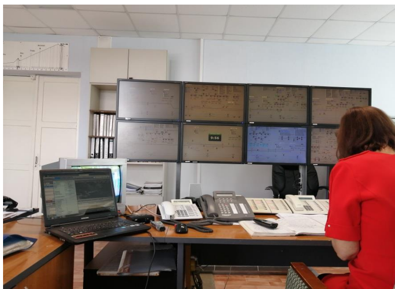
Рисунок 3.15 – Контроль установки переносной заземляющей штанги контактной сети на энергодиспетчерском пункте ст. Чусовская 29.03.2020г.
