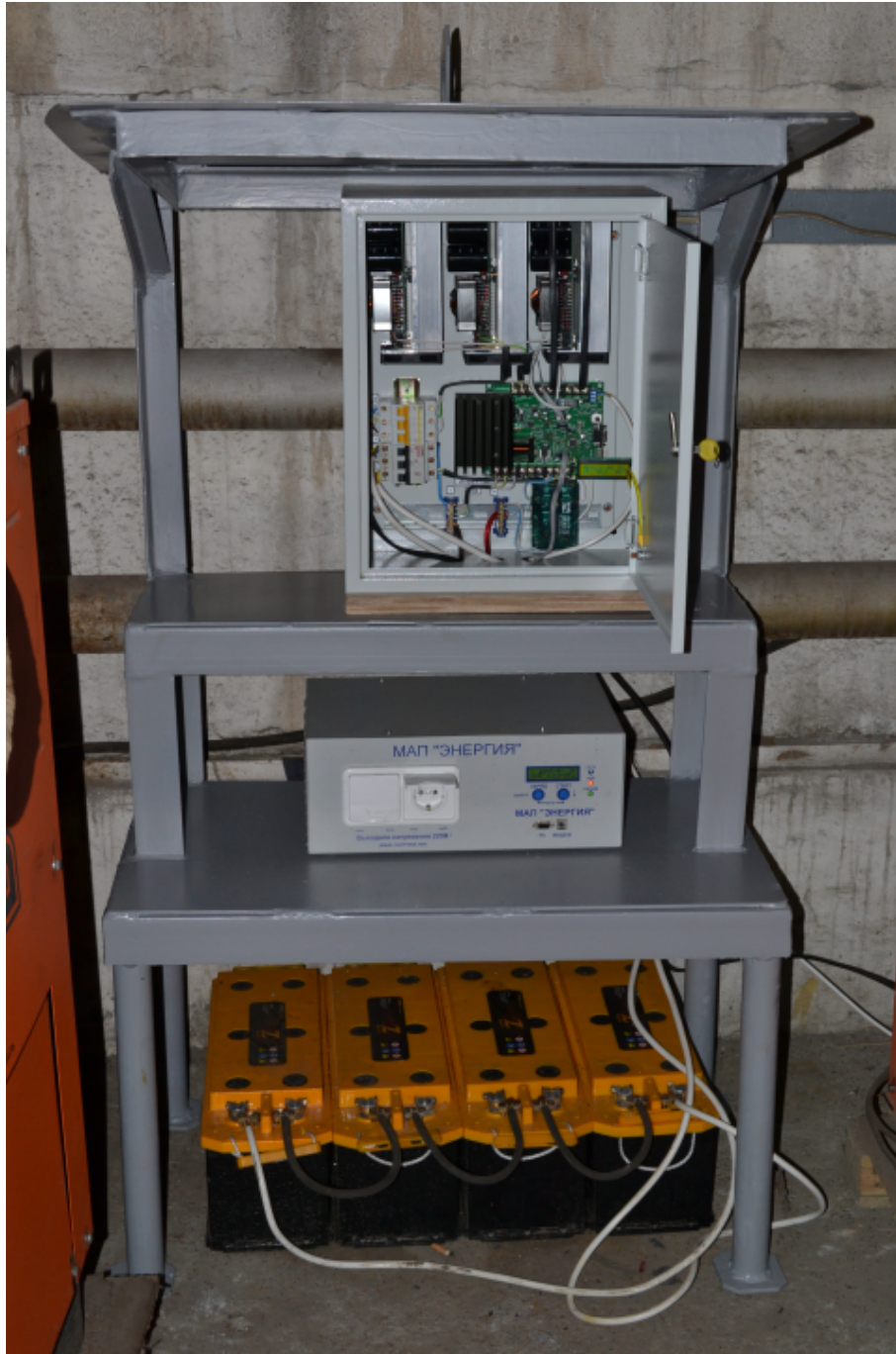
Рисунок 4.15 — Контроллер ВЭУ на испытательной площадке с подключенными АКБ и инвертором
