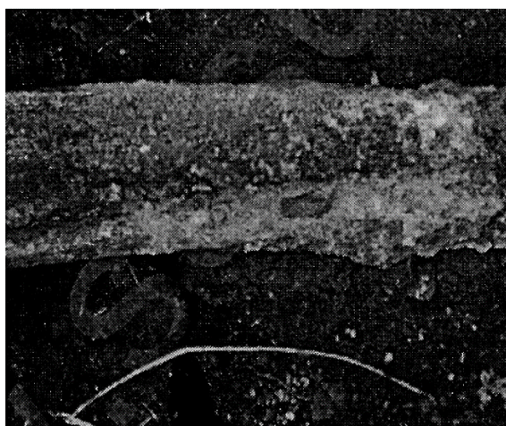
Рисунок 1.2 – Равномерное коррозионное разрушение элемента заземляющего устройства
