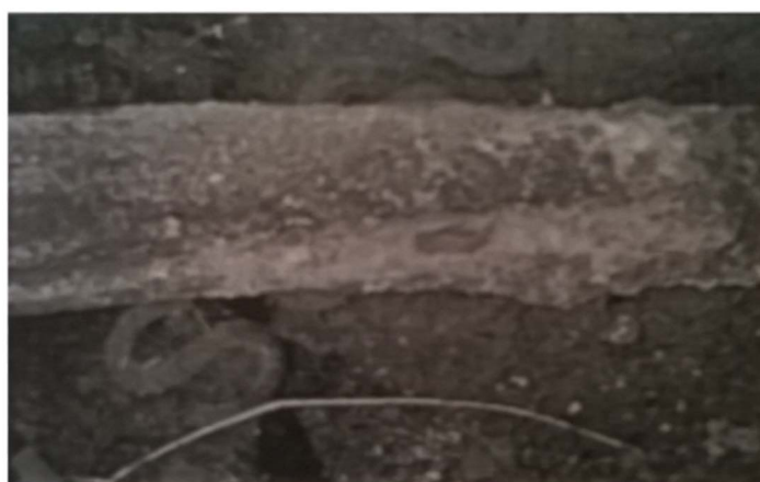
Рисунок 1.2 – Равномерное коррозионное разрушение элемента заземляющего устройства
