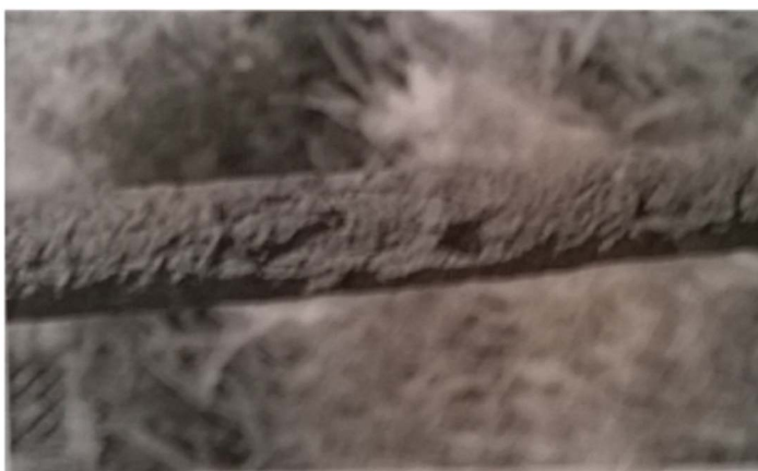
Рисунок 1.1 – Сочетание язвенных и локальных коррозионных повреждений
